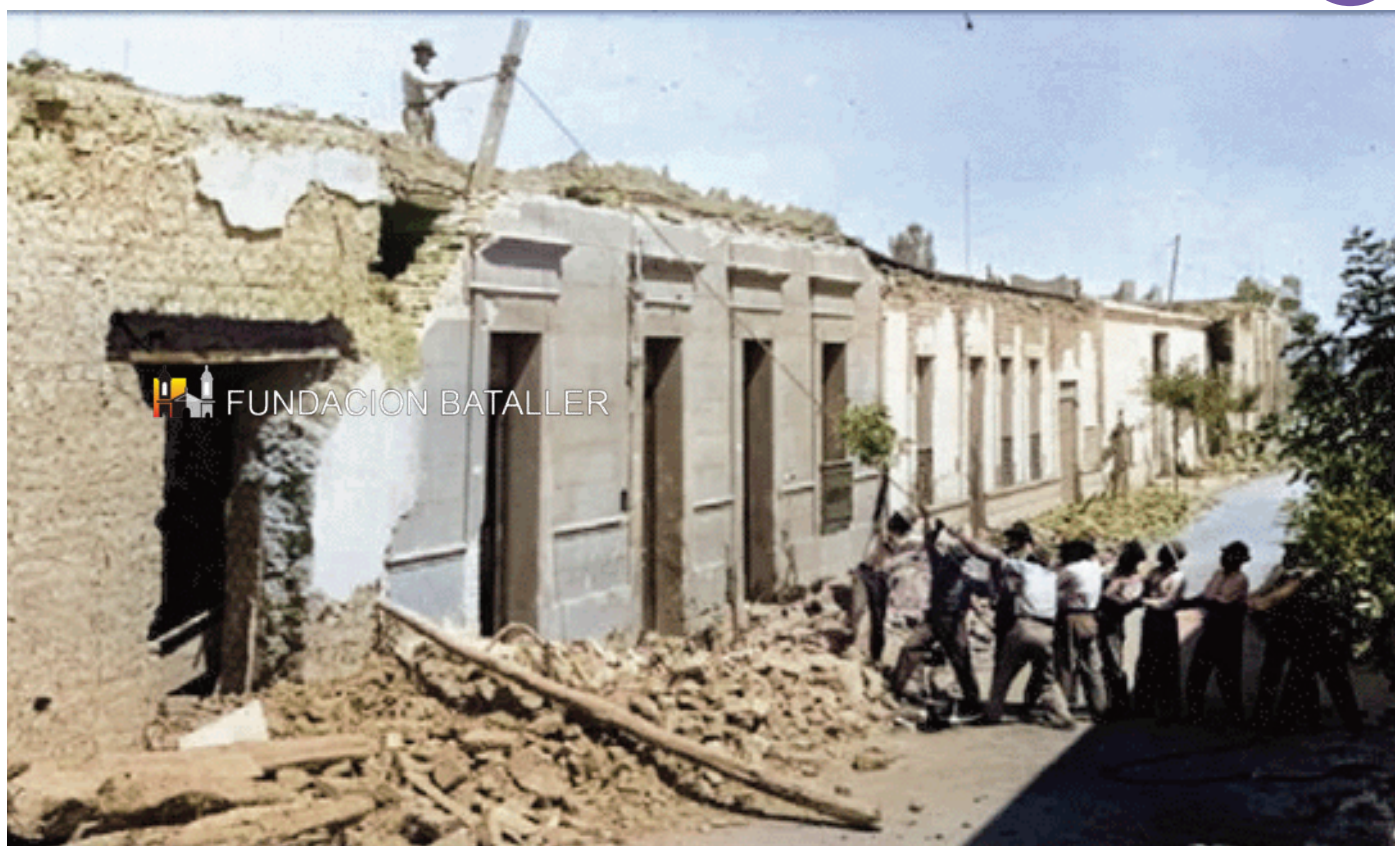
Oberos y voluntarios apuntalando los frentes destruidos.
