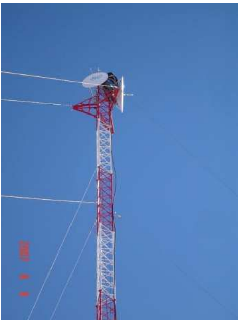
Figura 363 Torres y partes del enlace
