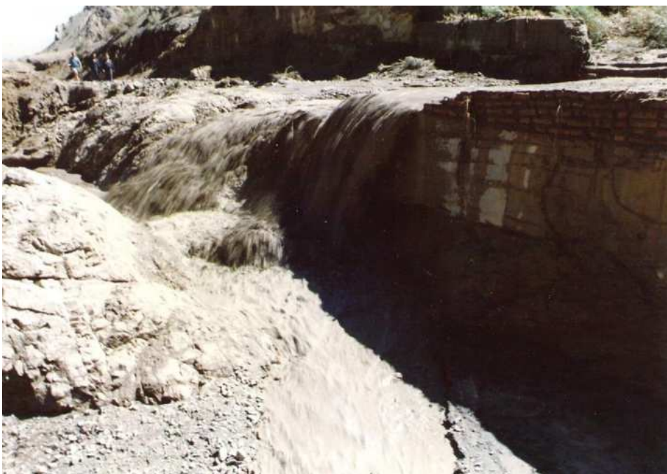
Figura 382. el segundo puente con acceso al sitio de telescopio y comedor también fue destruido
