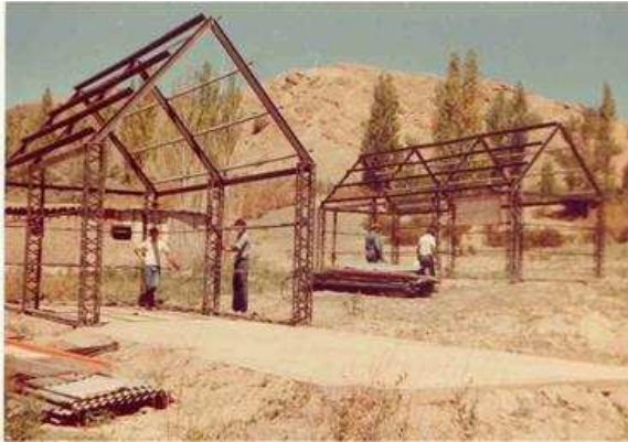
Figura 79 Galpones metálicos instalados en la zona de la Estancia.
