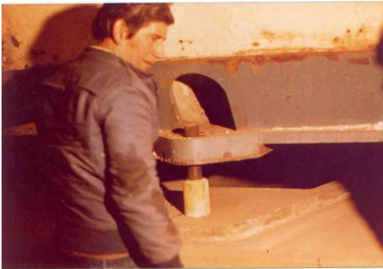
Figura 97 Instante de la colocación del pedestal del telescopio sobre los tres tornillos calantes hormigonados en el pilar
