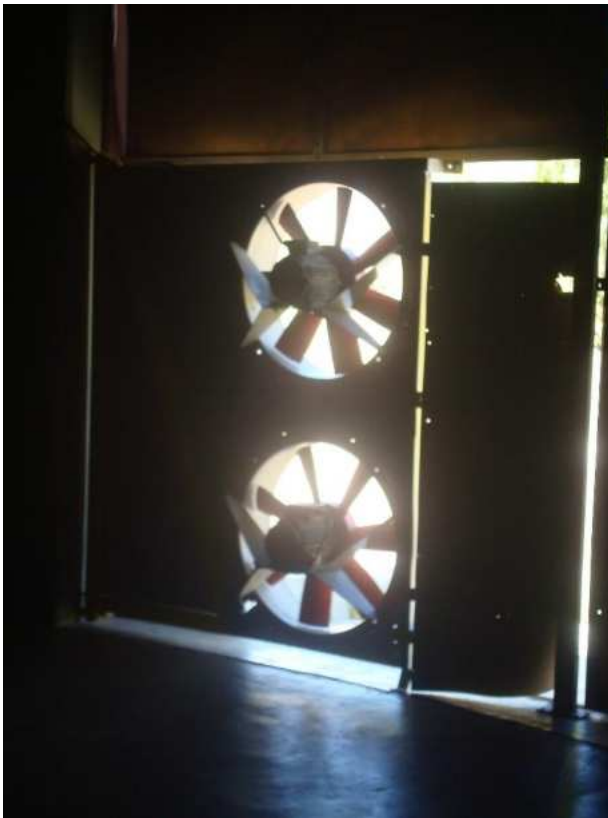
Figura 283 Extractores para uniformizar la temperatura del aire dentro de la cúpula con el exterior.
