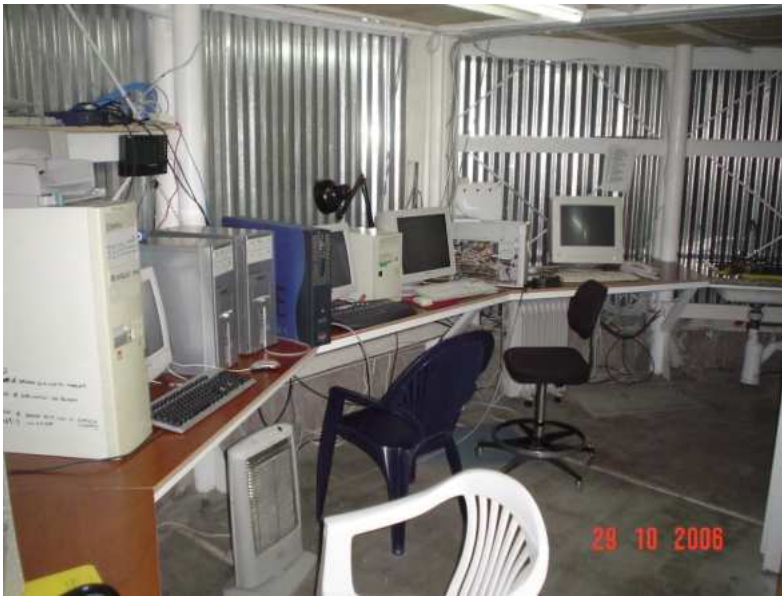
Figura 345 Sala de control en la planta baja del HSH.
